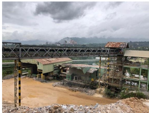
Gambar 5 Area yang belum dipasang Conveyor Belt Hood. (Sumber: Dokumentasi Lapangan, 2020)
